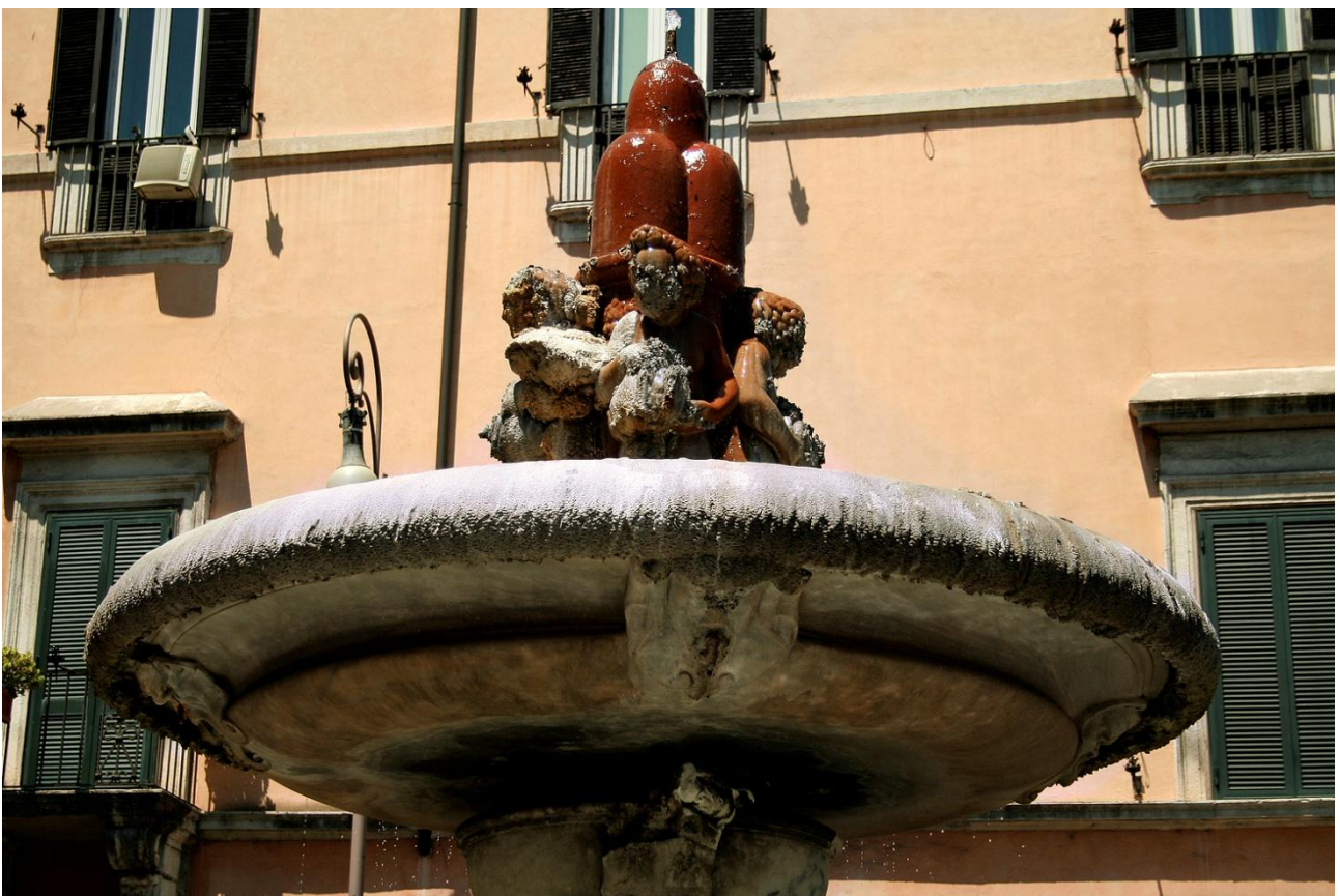
Depositi calcarei da carbonatazione del travertino sul bordo della fontana in piazza dell'Ara Coeli, Roma.
