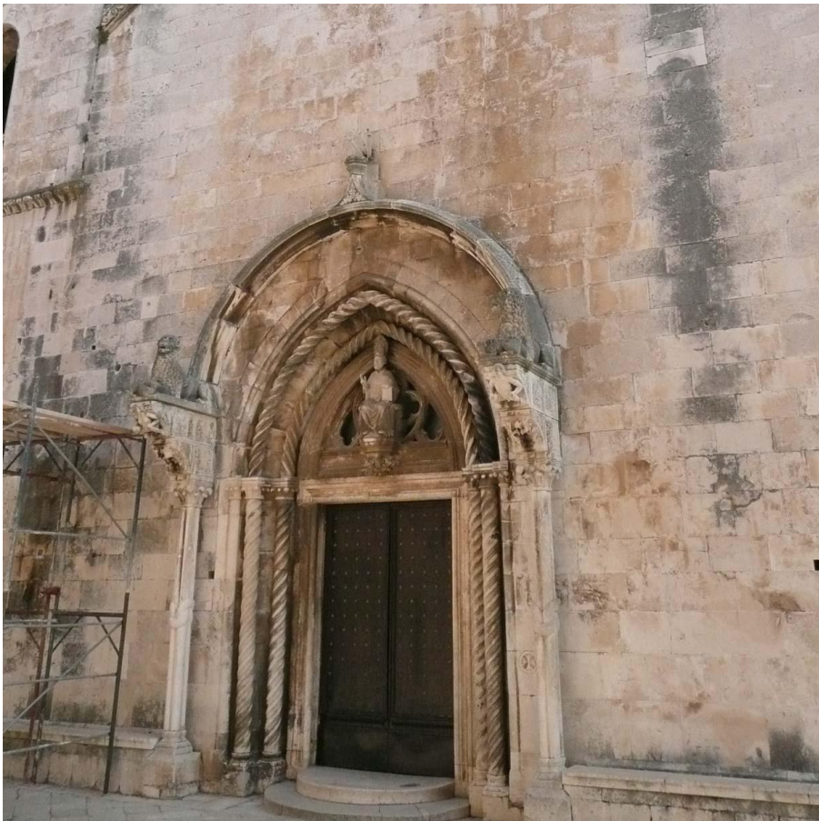
Facciata della cattedrale di Curzola prima del restauro. Le patine visibili sono state attribuite alla presenza di un'estesa colonia di cianobatteri.
