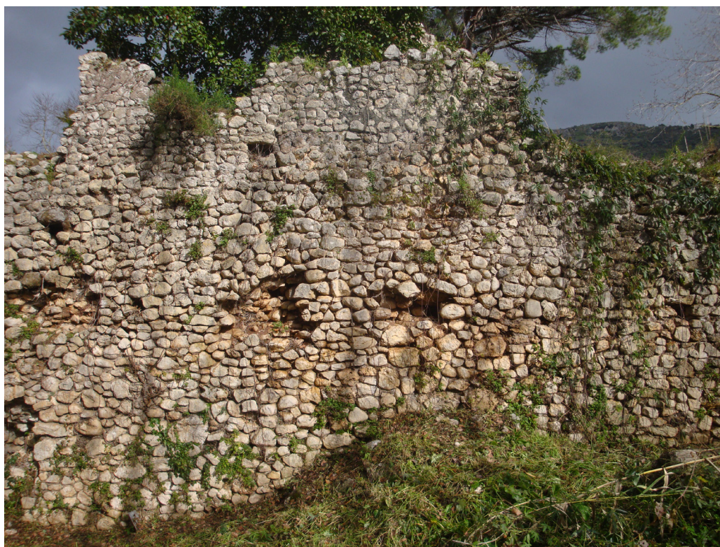
Fig. 5 – Ninfa, cinta muraria nei pressi del ponte del Macello. Degrado dovuto al deterioramento dei letti di malta.
