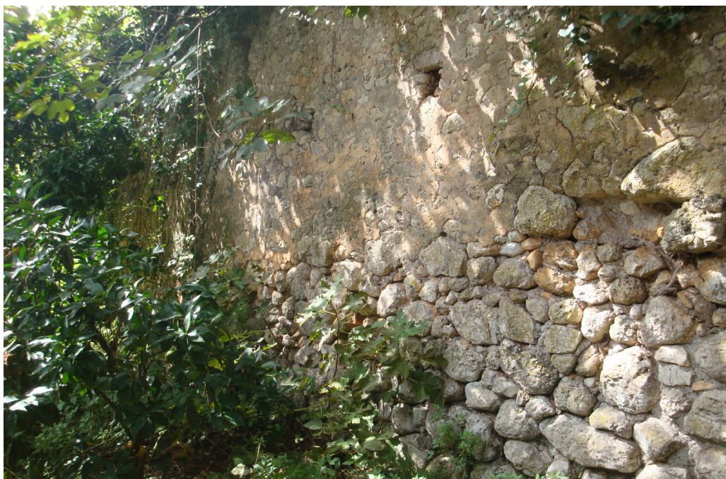
Fig. 1 – Ninfa, cinta esterna. Tracce della parziale demolizione e della successiva ricostruzione del circuito murario esterno nel tratto compreso fra la chiesa di San Biagio e porta Santa Maria (a-b).
