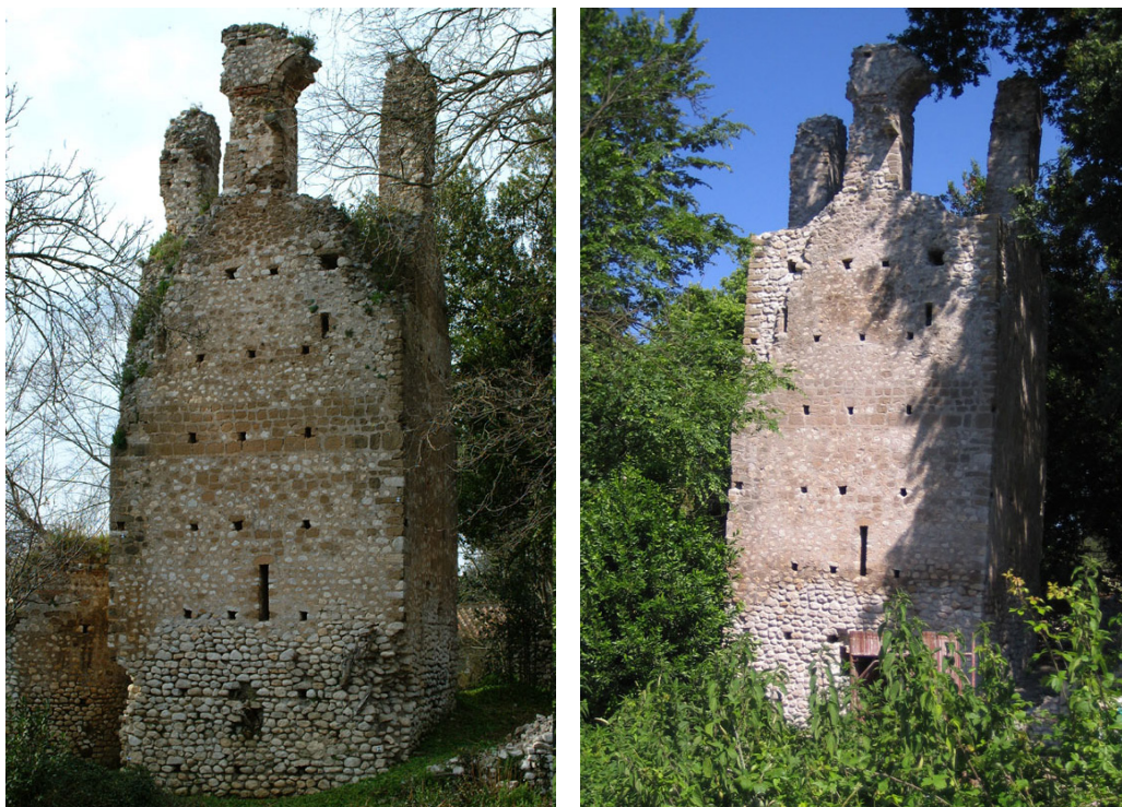
Fig. 4 – Ninfa, prospetto esterno del campanile della chiesa di San Salvatore prima e dopo l'intervento.
