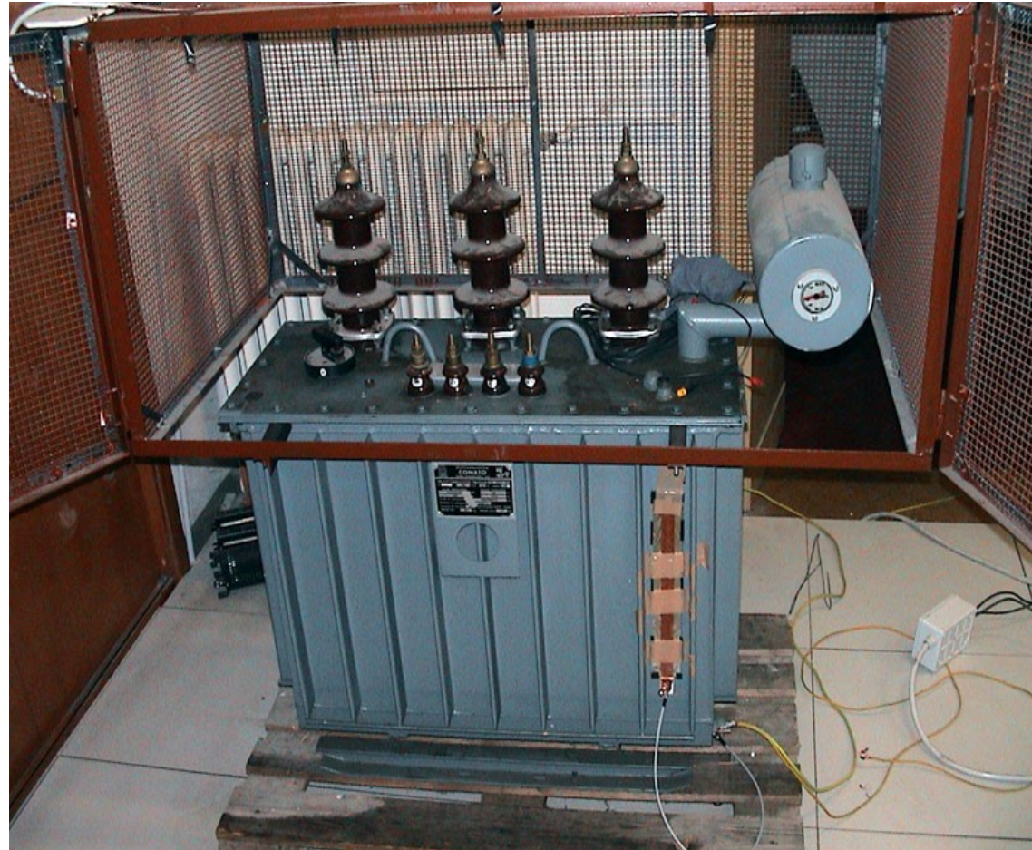
Trasformatore di distribuzione MT/BT in olio
