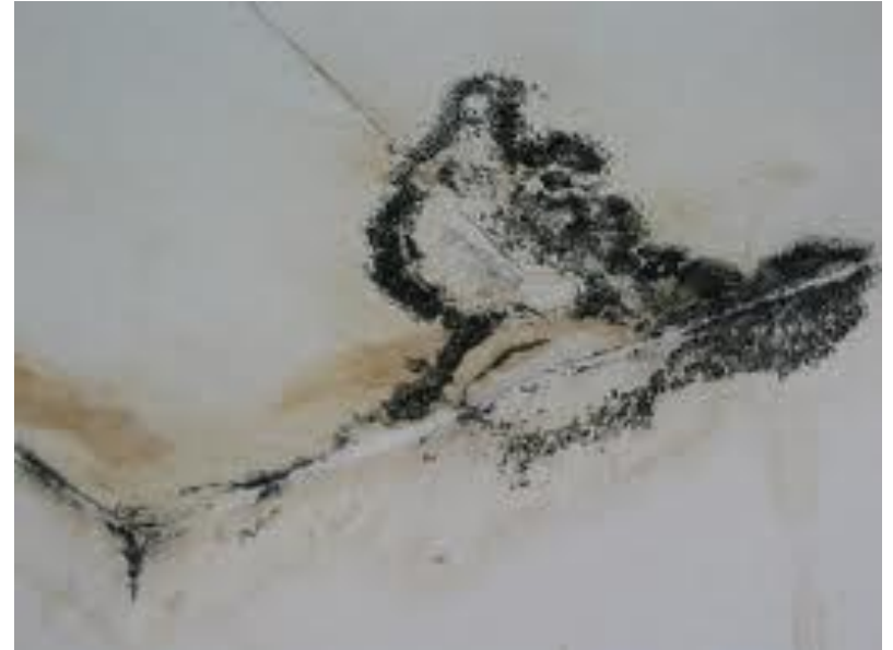
Muffa su muro
