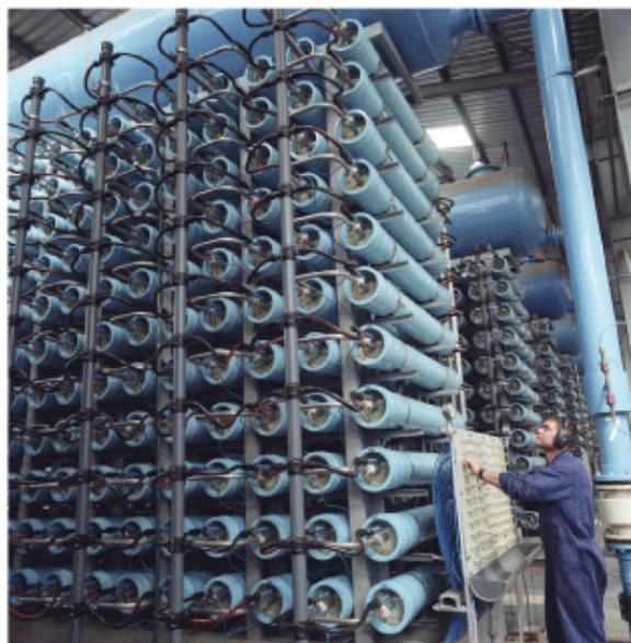
Impianto operante a osmosi inversa.
