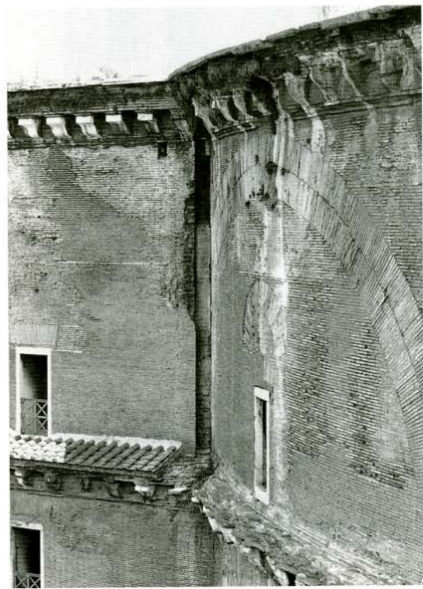
Fig. 33 Il giunto tra avancorpo e rotonda. All'altezza dell'anello superiore è evidente il distacco tra le due parti murarie, probabilmente eseguite in fasi diverse del cantiere.
