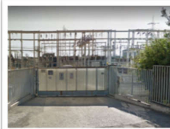
Servizi energia elettrica, via Grotta di Gregna
