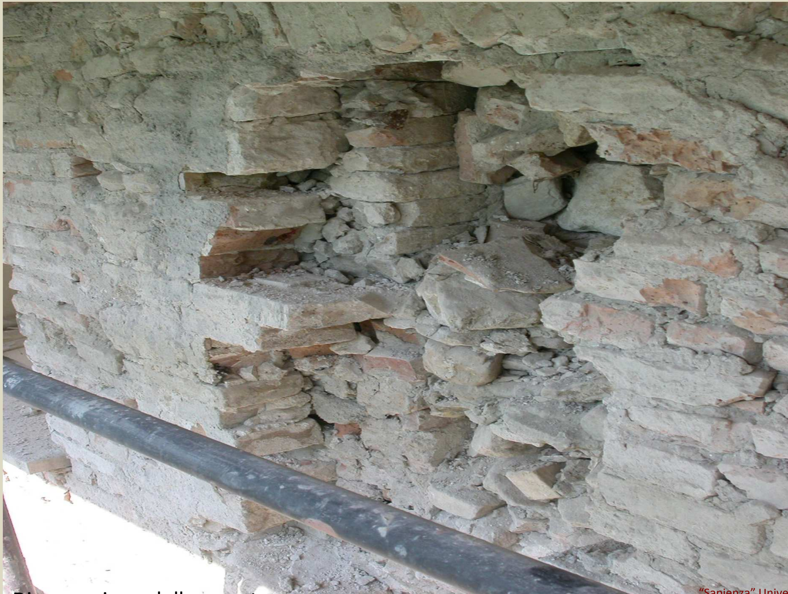
Disgregazione della muratura
