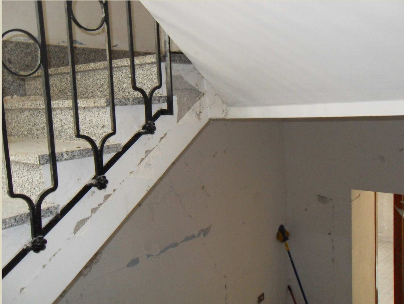
Scala in putrelle e tavelloni. Lesioni a livello delle putrelle
