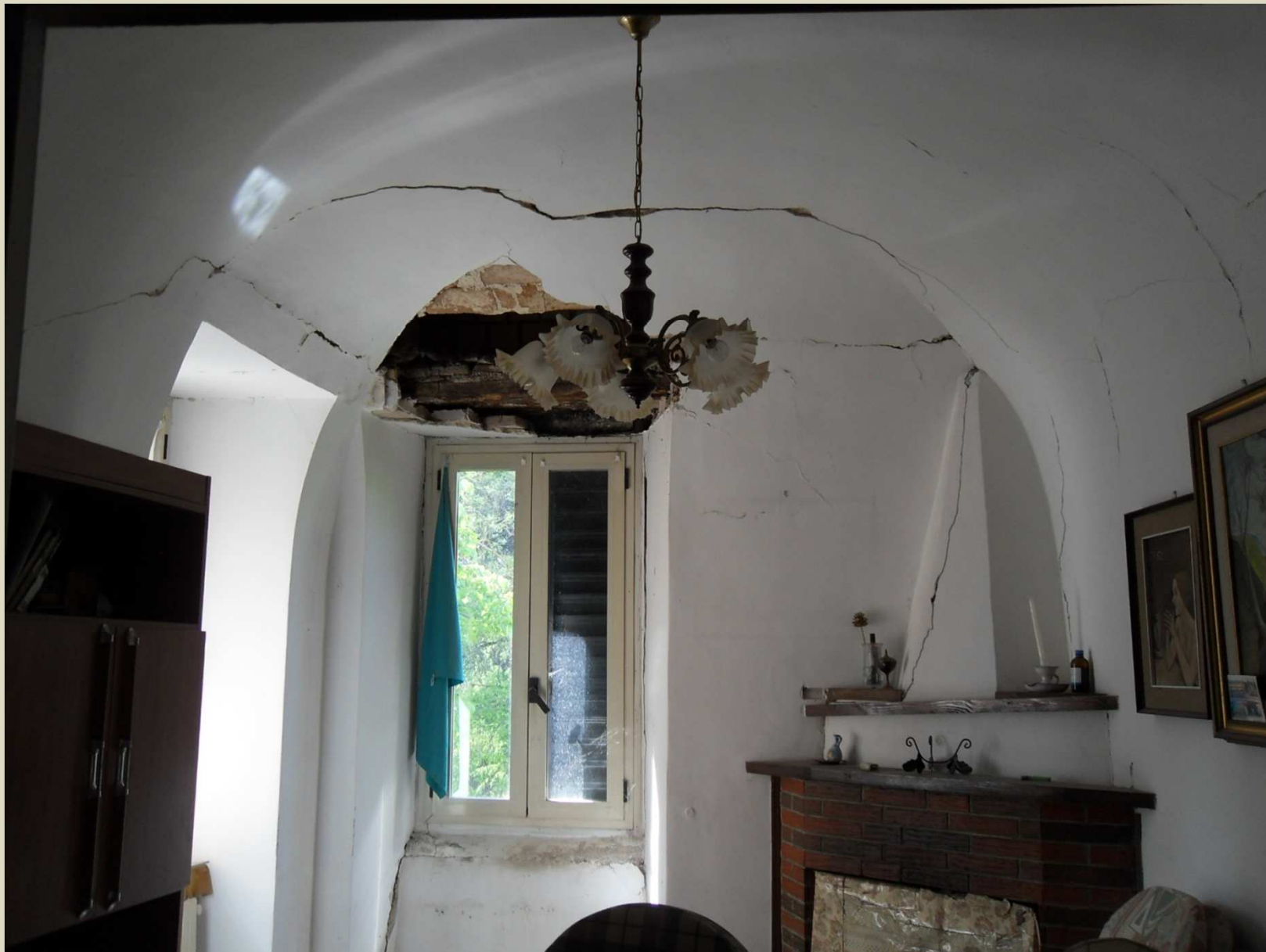
Crollo parziale di una volta a botte con mattoni pieni disposti in folio.
