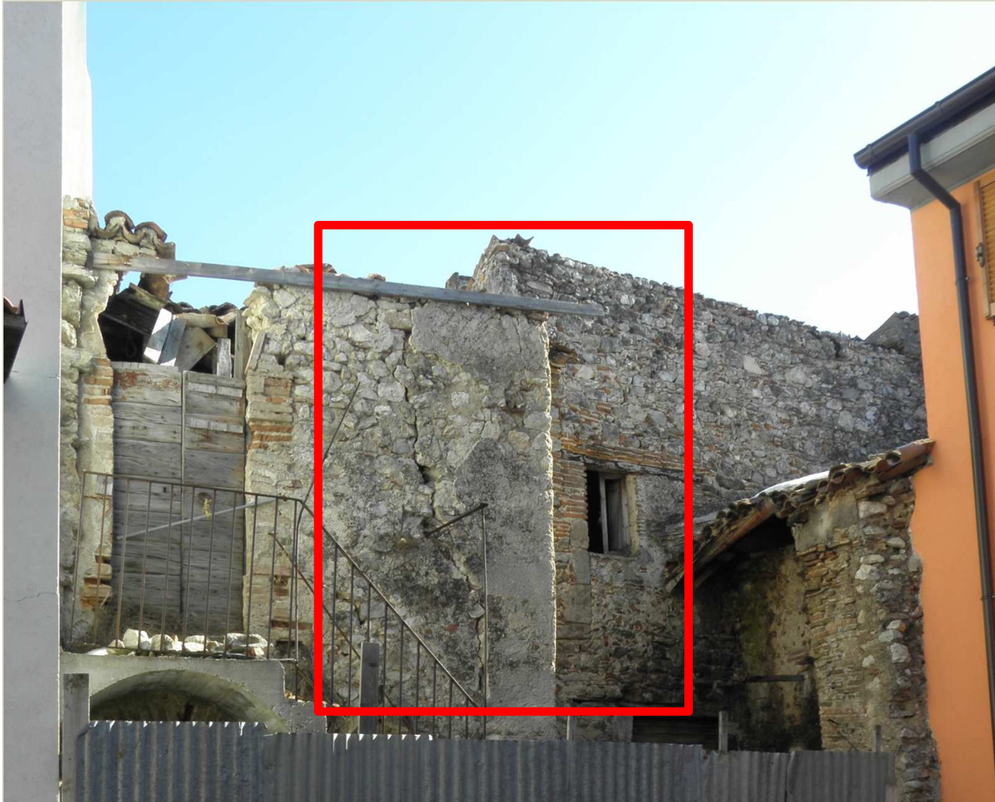
Ribaltamento composto di cuneo diagonale
