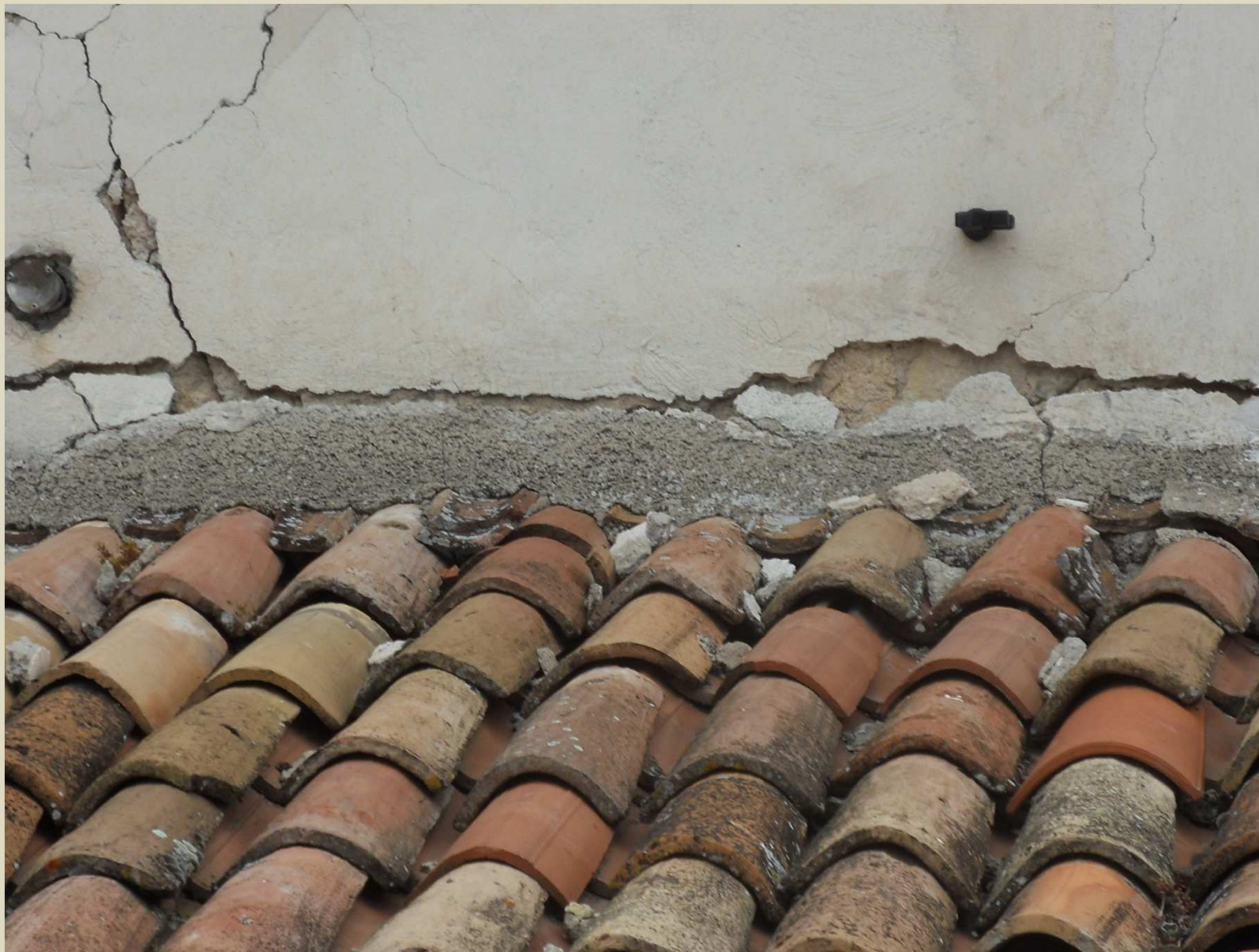
Lesione orizzontale per martellamento/sfilamento della copertura a quota inferiore
