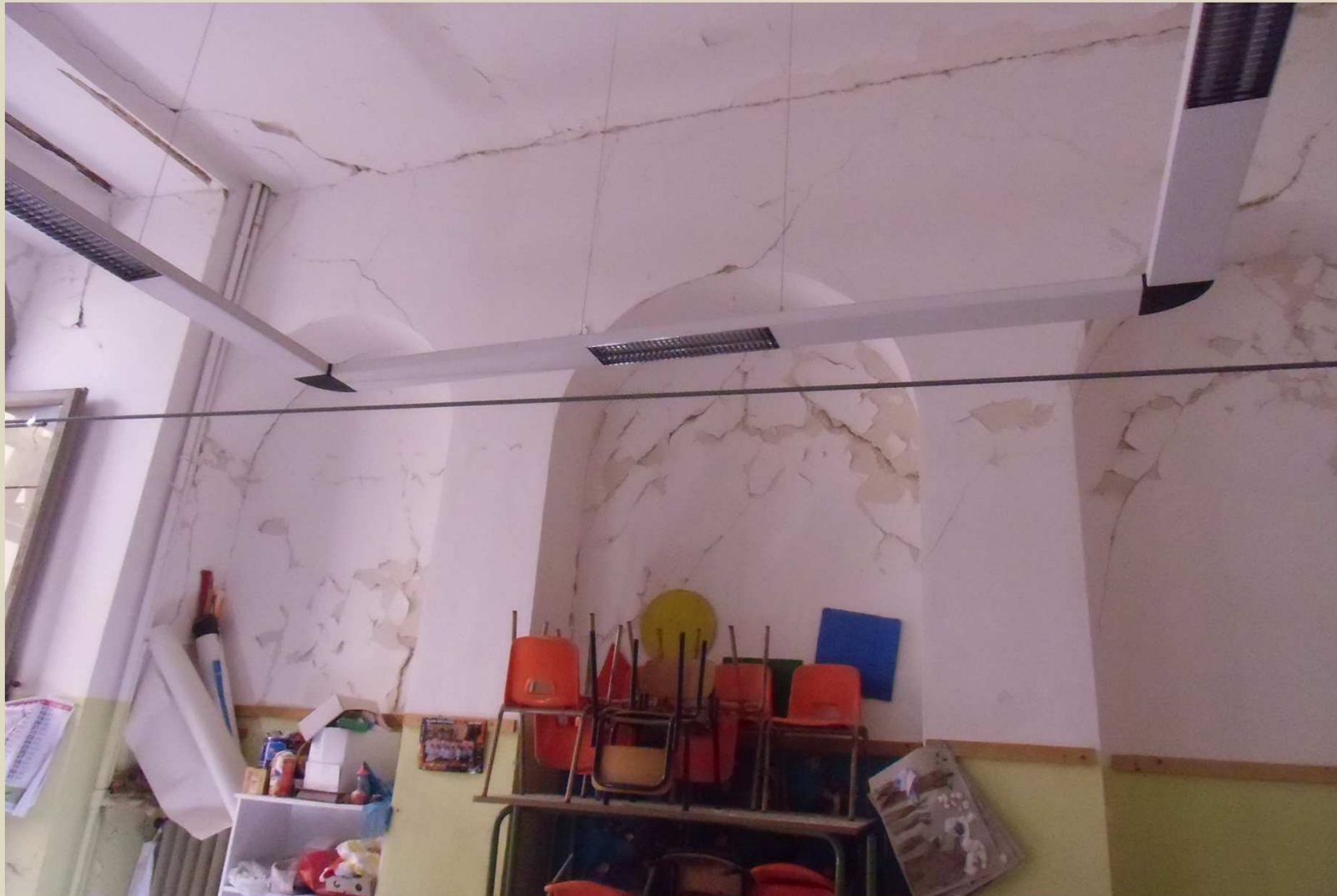
Lesioni passanti e diffuse in corrispondenza di una nicchia
