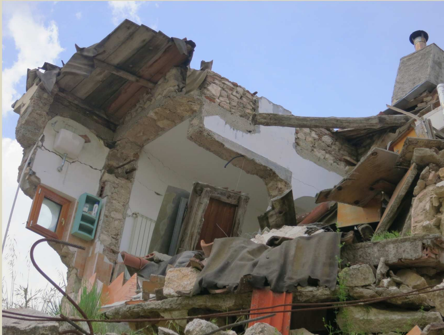
Onna (AQ): crolli dovuti a disgregazione della muratura
