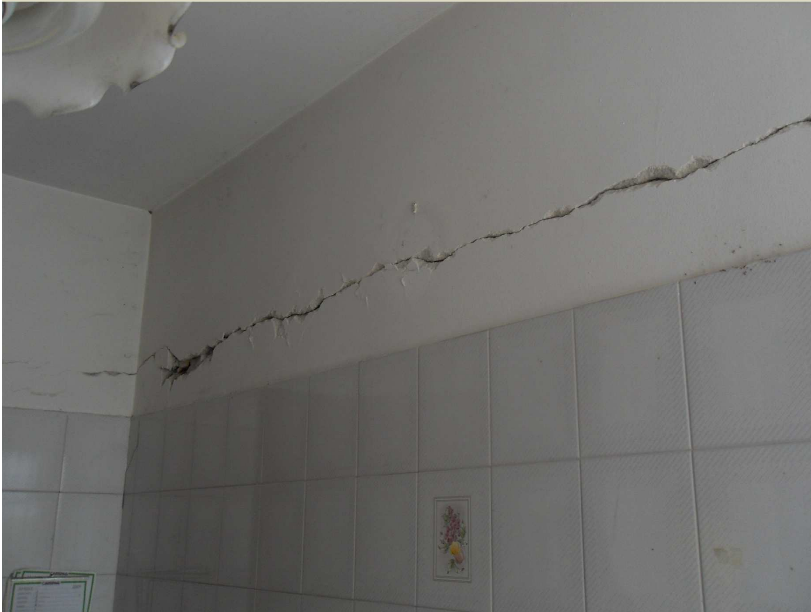
Lesione profonda orizzontale sulla muratura
