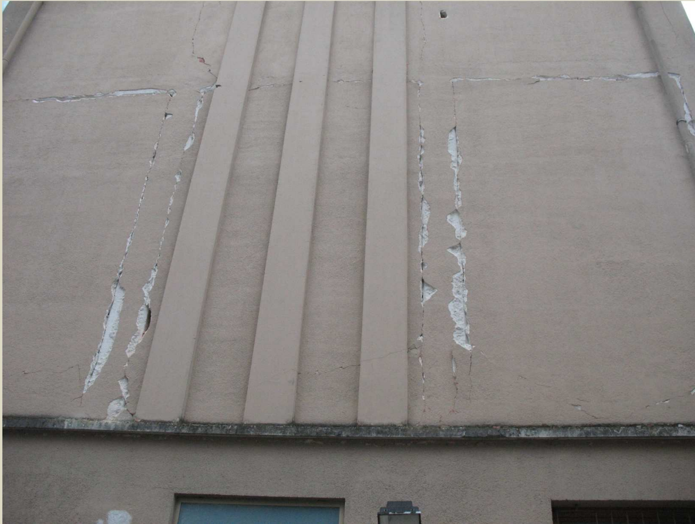
L'Aquila: esterno dell'edificio ex Isef - lesione in corrispondenza della tamponatura in prossimità del telaio strutturale
