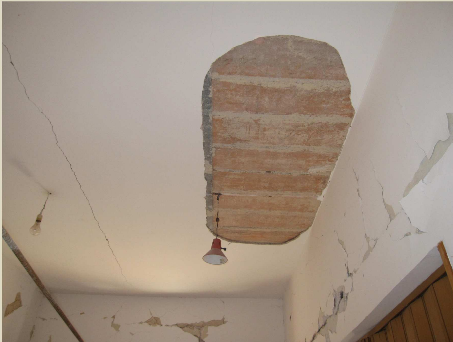
Distacco di intonaco dal solaio e lesioni in corrispondenza delle putrelle
