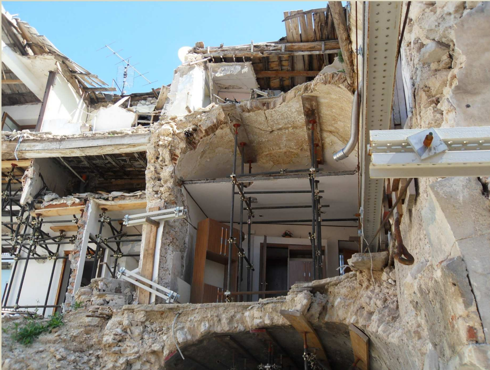
Crollo di porzione di volta a botte con mattoni pieni
