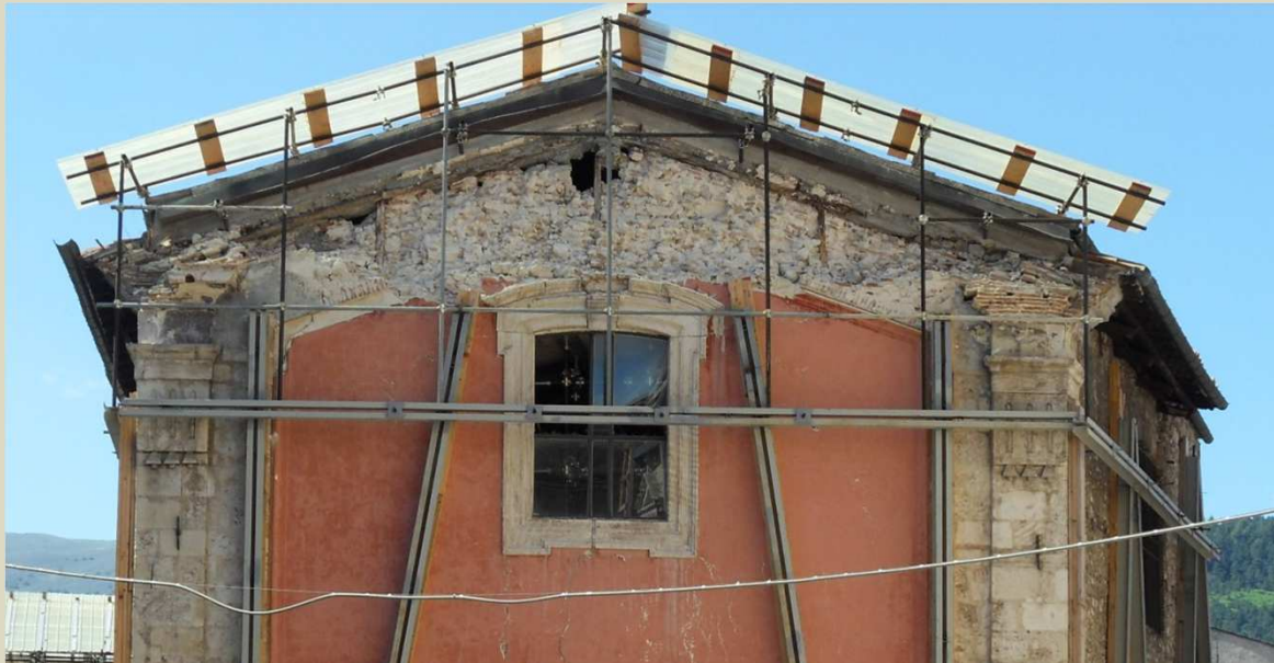
SFONDAMENTO DELLA PARETE DEL TIMPANO
