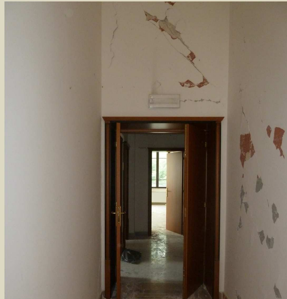
Lesioni dagli angoli delle aperture Lesioni a croce su un'apertura
