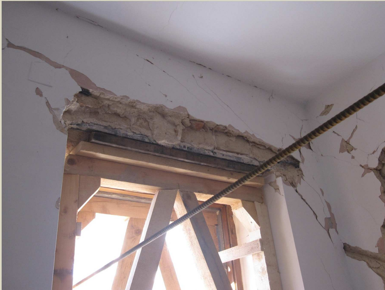
Crollo dell'architrave in muratura
