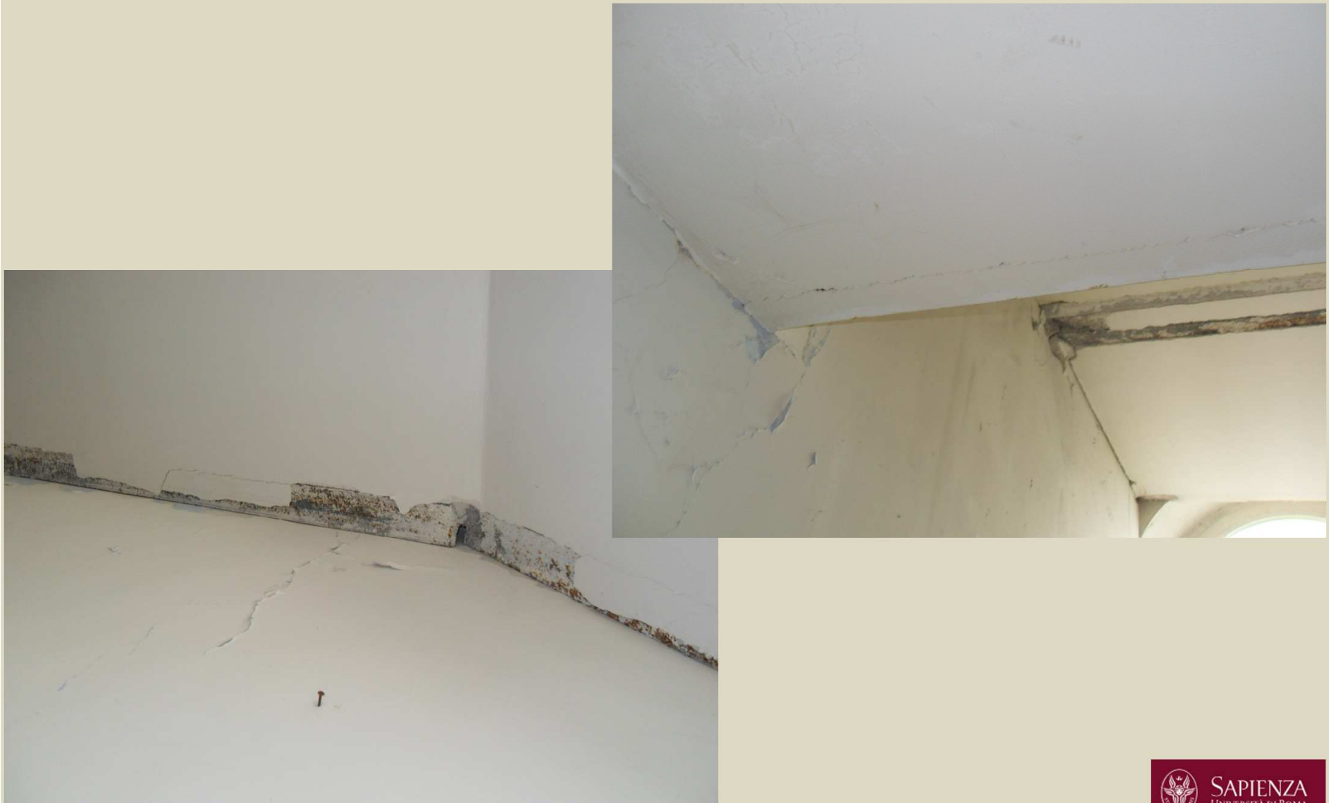
Scala in putrelle e tavelloni. Lesioni a livello delle putrelle sulla rampa e sul pianerottolo.
