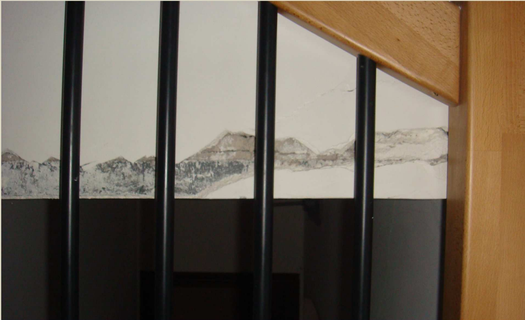
Solaio visto da una vano scala. Fessure in corrispondenza delle putrelle
