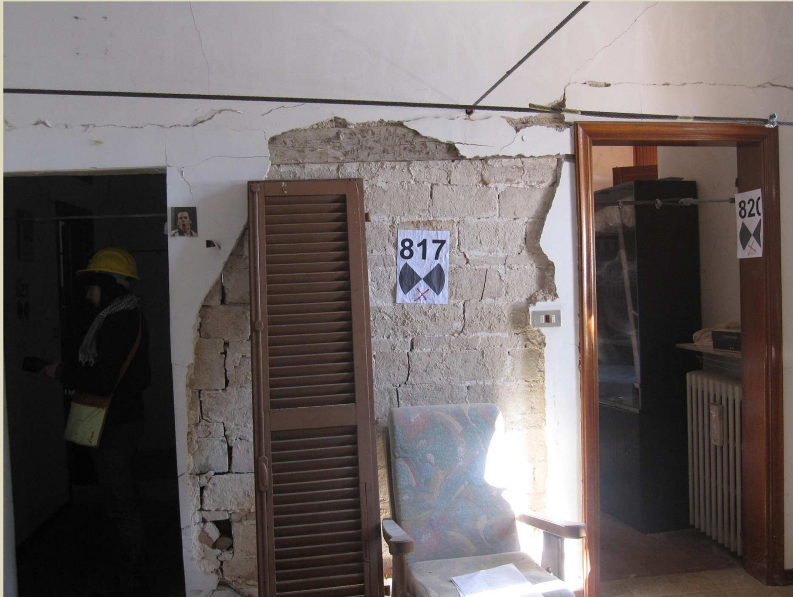
Lesione diagonale sulla muratura
