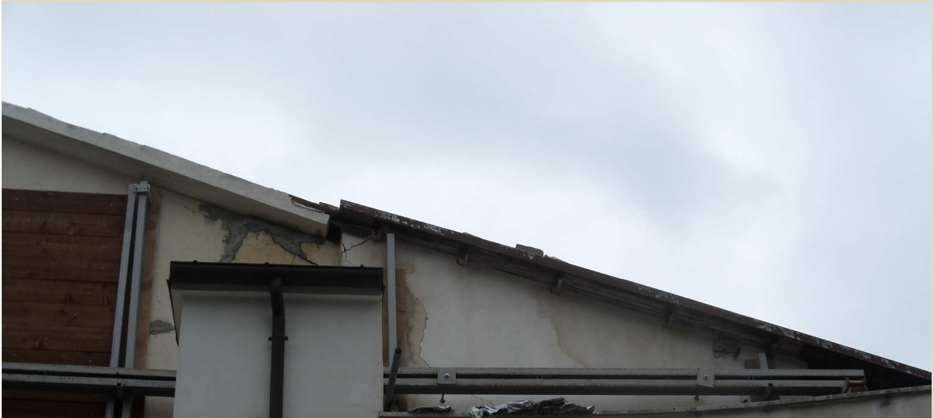
Lesioni di martellamento tra le due coperture
