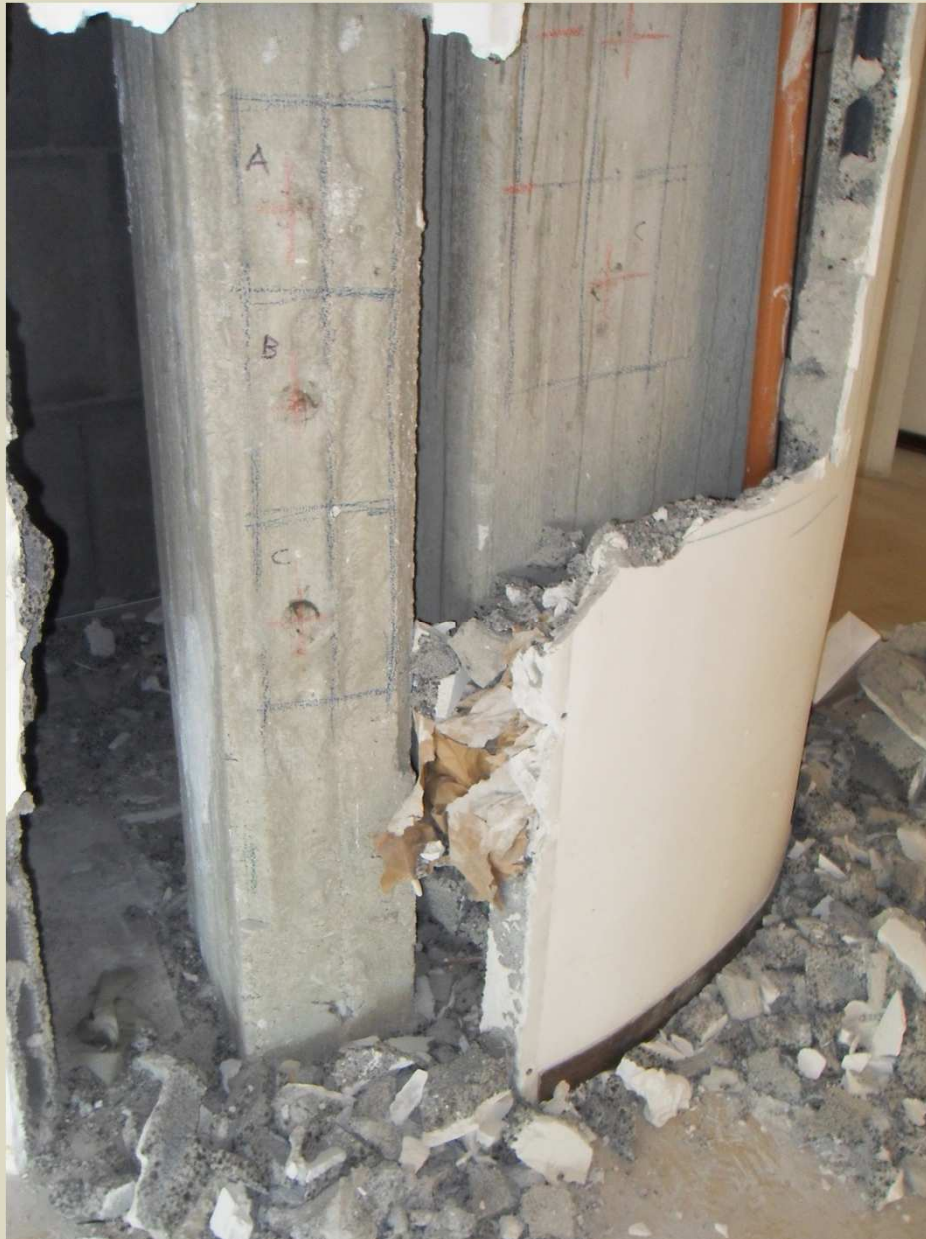
Espulsione della muratura
