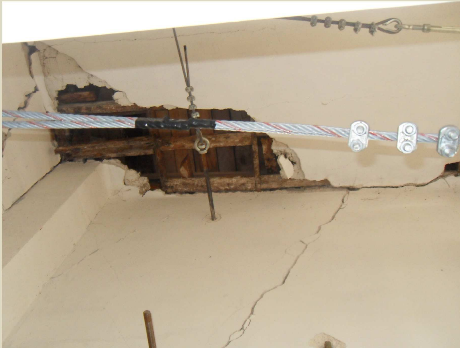
Solaio in legno: crollo parziale
