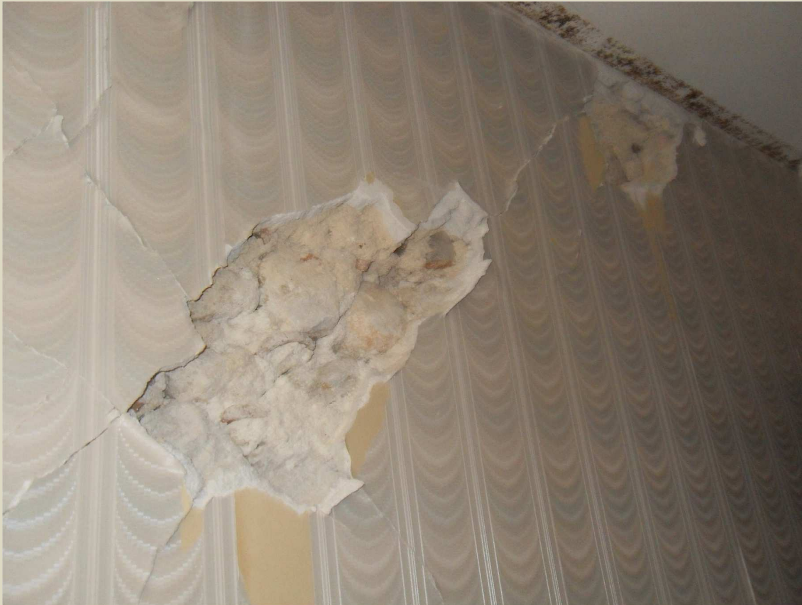
Lesioni a croce sulla muratura
