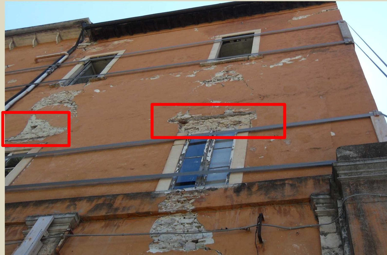
Lesioni della muratura in corrispondenza degli architravi in legno
