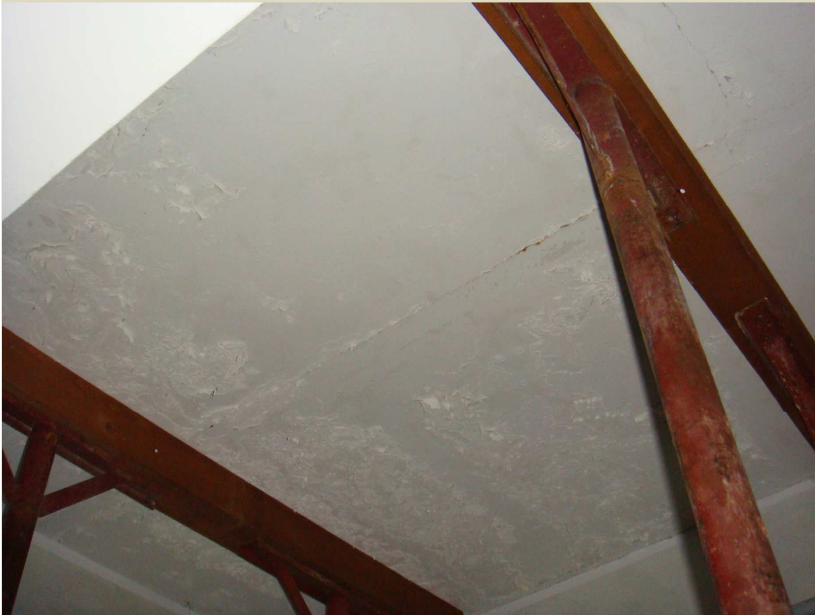
Lesioni su solaio in corrispondenza delle putrelle
