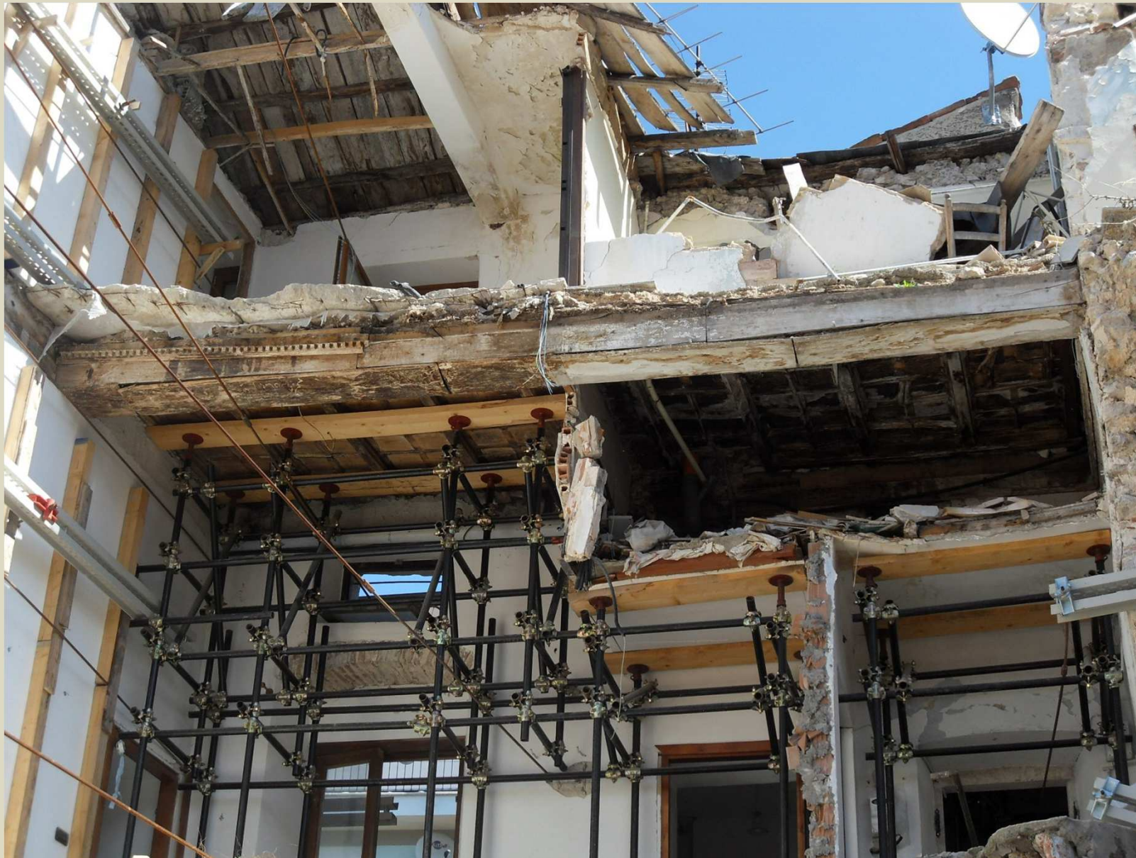
Solaio in legno: crollo parziale per sfilamento delle travi dalla muratura
