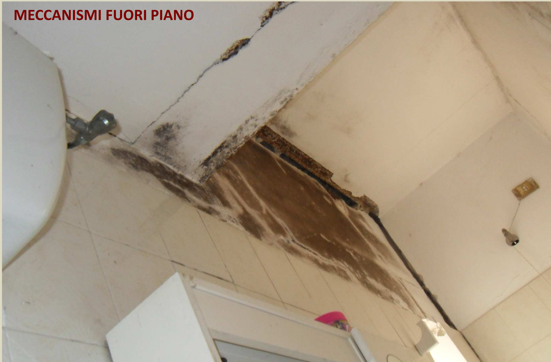
Distacco della muratura perimetrale dal solaio con rischio ribaltamento
