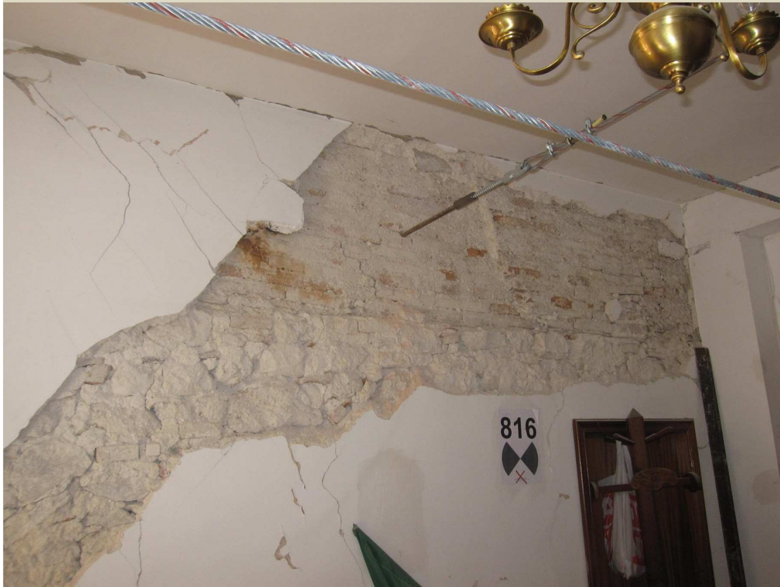
Lesioni profonde sulla muratura, distacco totale di intonaco
