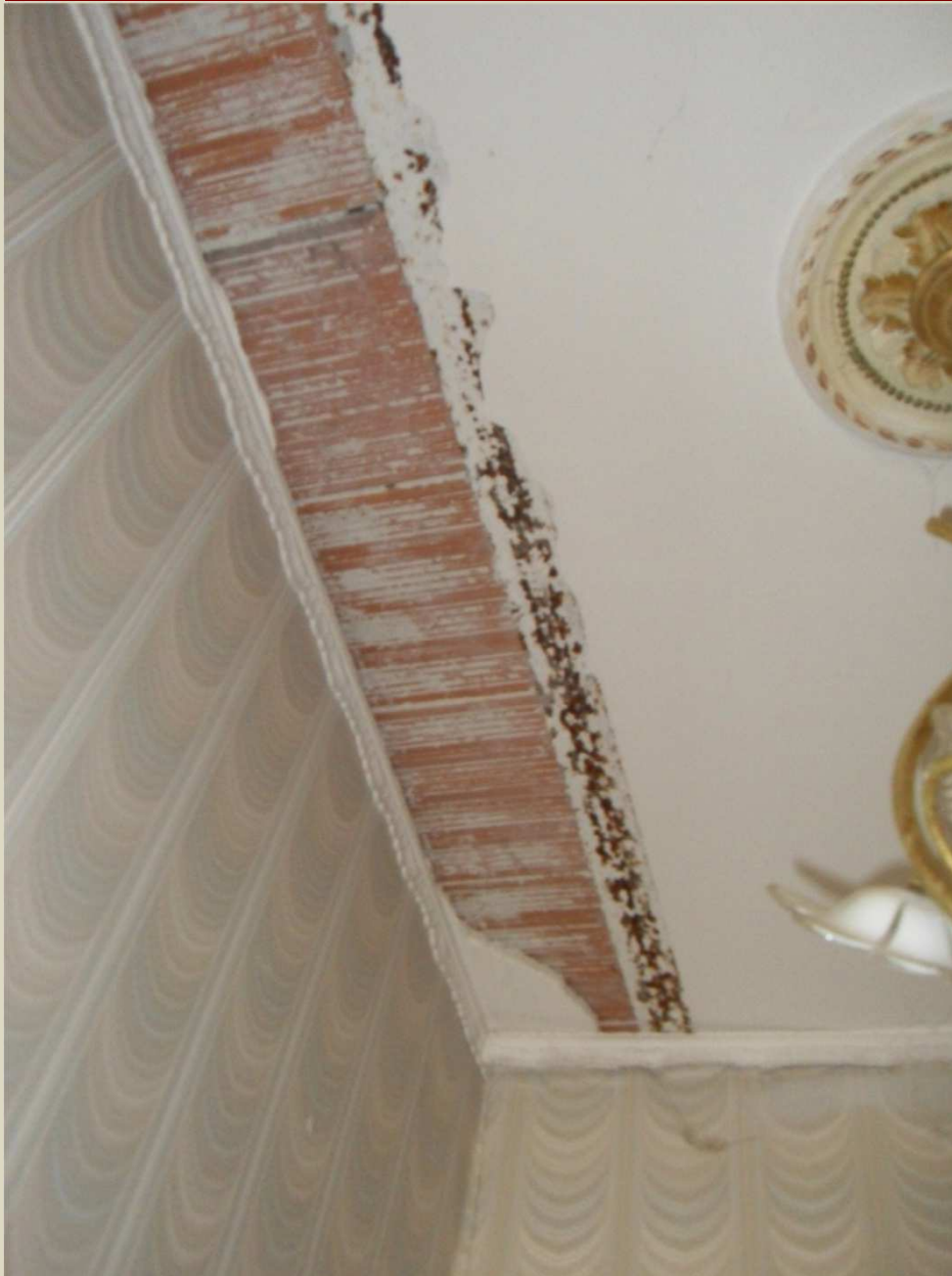
Distacco di intonaco dal solaio.
