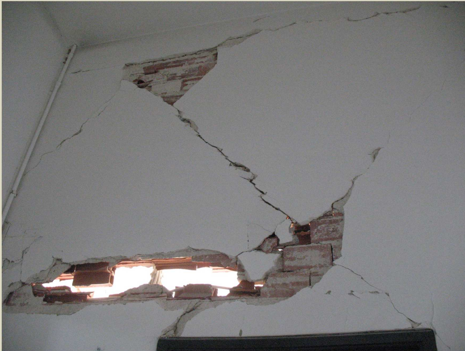
L'Aquila: interno dell'edificio ex Isef - lesione in corrispondenza dell'apertura
