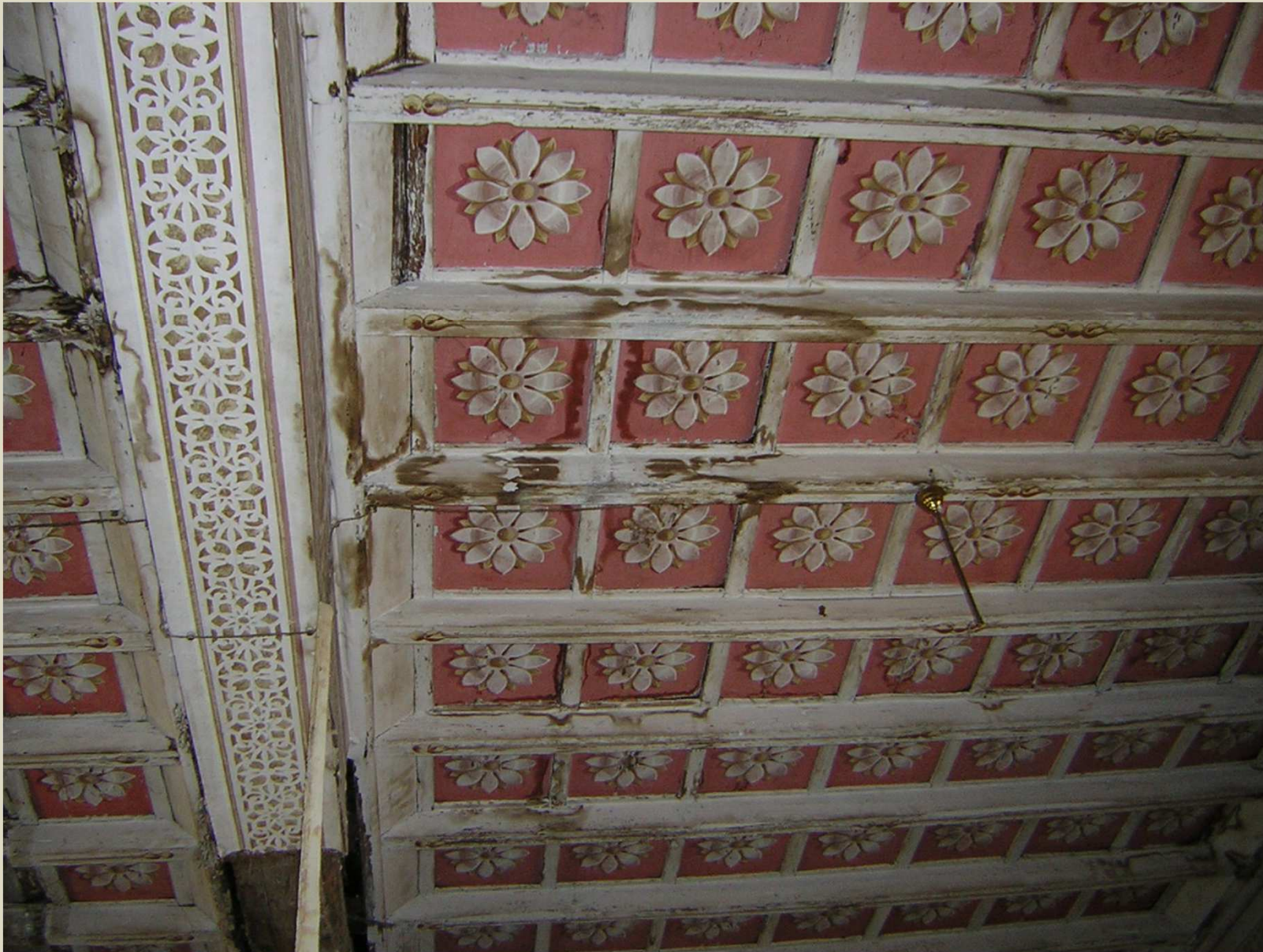
Cassettonato in legno: umidità
