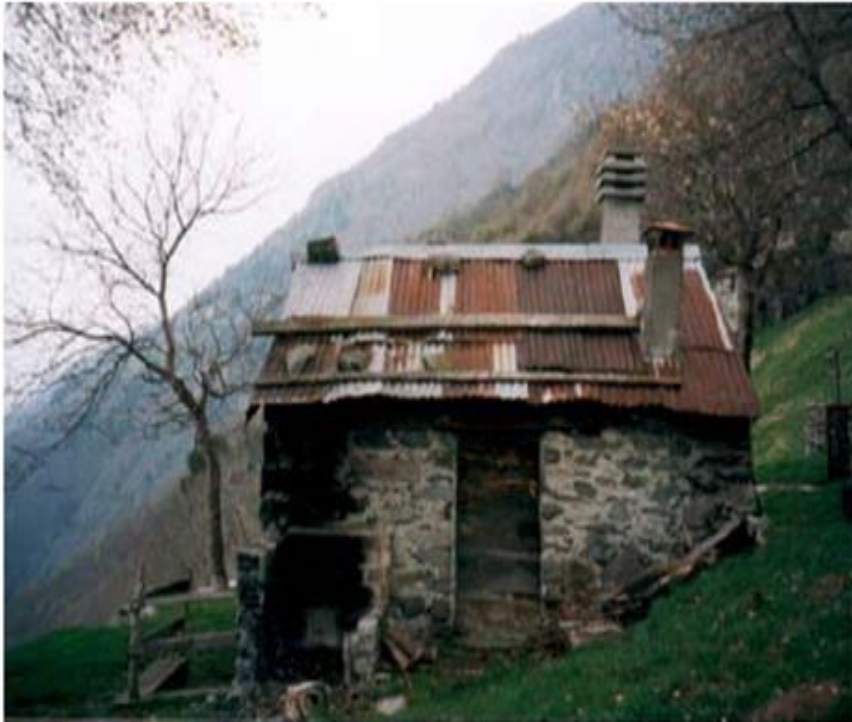
Fig. 1.4 - Corrosione generalizzata di lamiera zincate sul tetto di una baita a Nestrelli (Valtellina)
