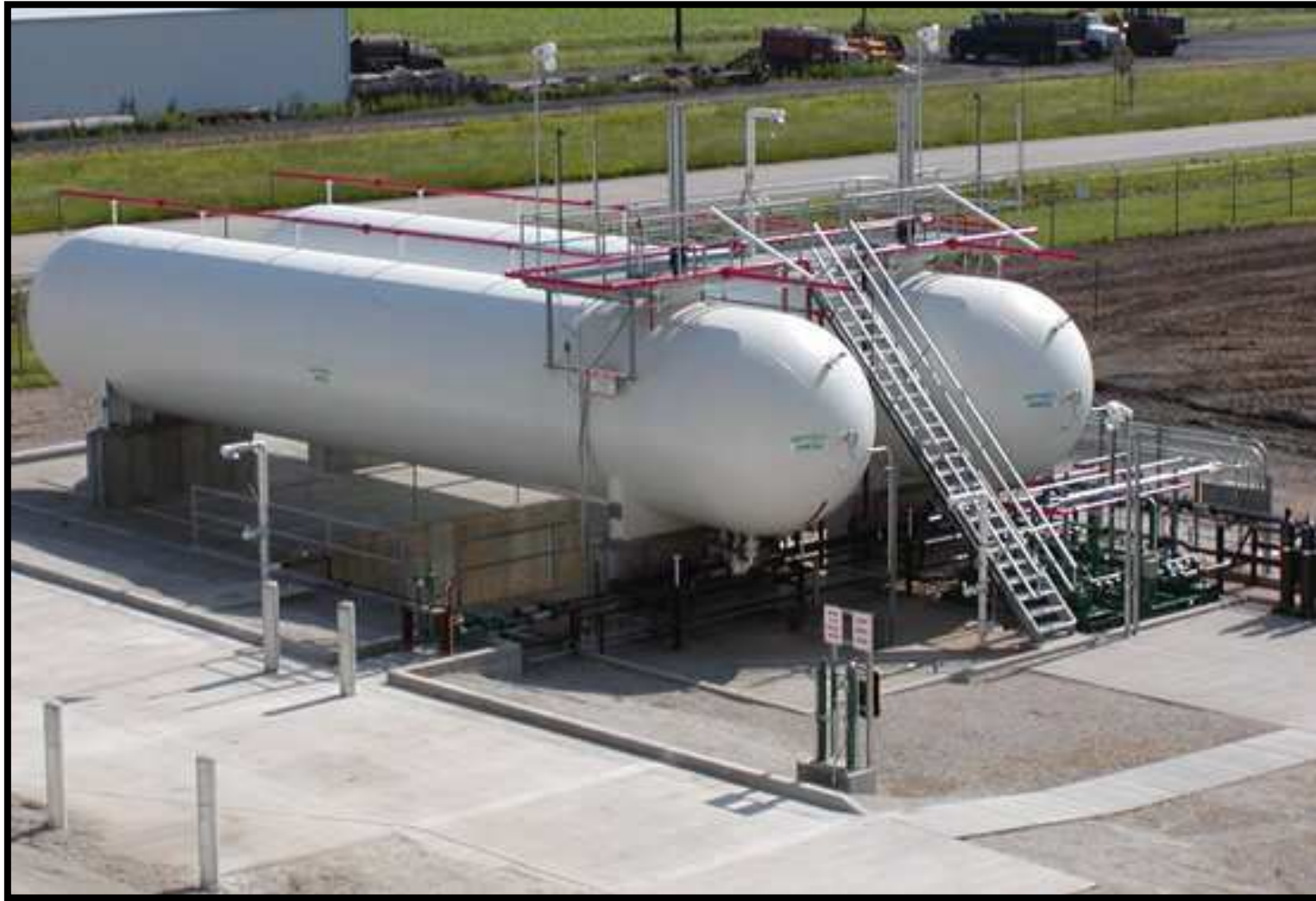
Serbatoi di stoccaggio della soluzione ammoniacale
