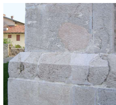
Discontinuità e laminazione esterna di un concio sollecitato dalla cerniera del meccanismo di crollo.
