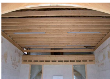
Immagini da sotto e da sopra dell'antico tetto conservato e delle lame in legno poste nella posizione del soffitto centrale perduto.
