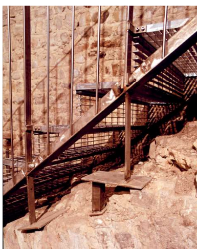
La prima rampa della scala, priva delle pedate, e la collocazione della scala in metallo appoggiata a secco.
