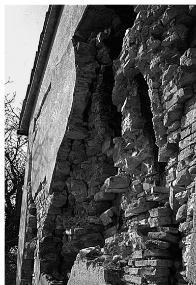
Comportamento disgregativo della muratura nella chiesa di Collecorti, a seguito del terremoto del 1997.
