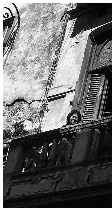
Casa senza più il tetto, abitata al piano sottostante, sulla strada principale de L'Avana Vecchia. Il confine ritenuto necessario per la sopravvivenza della casa, per l'uso e per la sicurezza degli abitanti si sposta talvolta in modo marcato.
