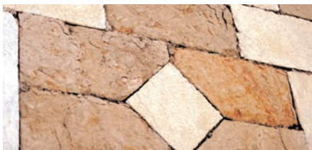
e) Degrado fisico: esfoliazioni dovute a gelività sulla pietra rosa della facciata di S. Maria di Collemaggio all'Aquila.
