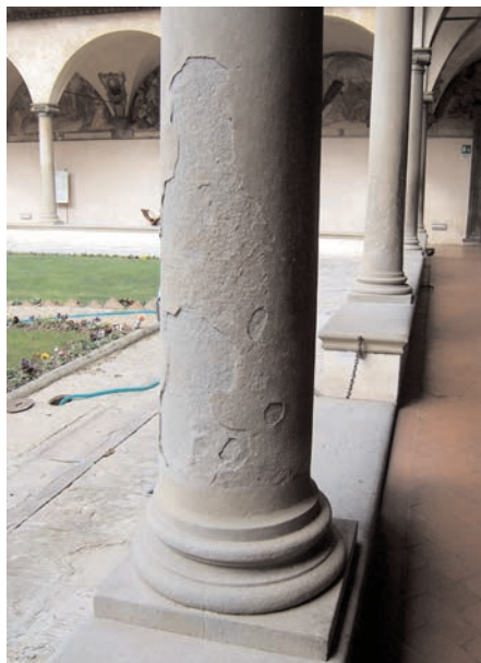
d) Degrado chimico: lisciviazione. La colonna in pietra serena (arenaria), nel chiostro del convento di S. Marco a Firenze, è interessata da fenomeni di esfoliazione dovuti alla formazione di una crosta superficiale, ricca in cemento calcitico, meno porosa, che tende a distaccarsi. Tali croste si formano per dissoluzione della calcite che si trova all'interno della pietra e successiva precipitazione nella porosità della parte più superficiale (foto di F. Fratini).
