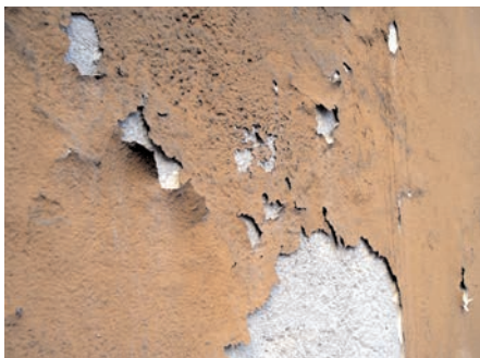
e) Degrado di una pittura con effetto "pellicolante". L'uso di rivestimenti sintetici su murature antiche è di per se stesso causa di degrado, in quanto tali pitture hanno caratteristiche idrorepellenti che impediscono la normale traspirazione della muratura.
