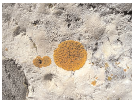
b) Degrado biologico: licheni su una muratura calcarea in zona extraurbana, nei dintorni dell'Aquila (Gran Sasso). Questo tipo di degrado è caratteristico delle zone poco inquinate.
