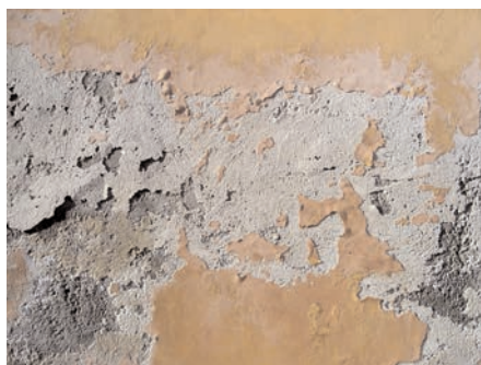
d) Degrado di una tinteggiatura dovuto a problemi d'incompatibilità con il supporto.
