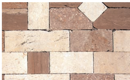
b) Il paramento lapideo della facciata di S. Maria di Collemaggio all'Aquila è caratterizzato da un disegno bicromo realizzato con conci in calcare bianco e rosa. Nel particolare si nota che alcuni elementi sono in breccia rosata, mentre la maggior parte dei conci è in calcare compatto.
