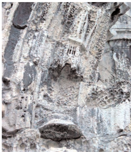
b) Degrado fisico-chimico: erosione ed alveolizzazione sul portale della chiesa di Saint-Sauveur a La Rochelle (Francia). In questo caso, la presenza di croste nere fa pensare ad un'aggressione ambientale dovuta anche all'inquinamento.
