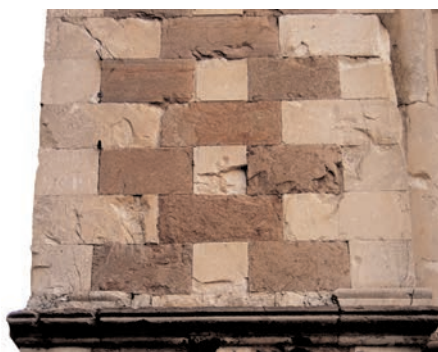
a) Degrado meccanico: lesioni e fratturazioni sul paramento lapideo di S. Maria di Collemaggio all'Aquila. Esempio di interazione tra problemi strutturali (solicitazioni sismiche) e degrado delle superfici.
