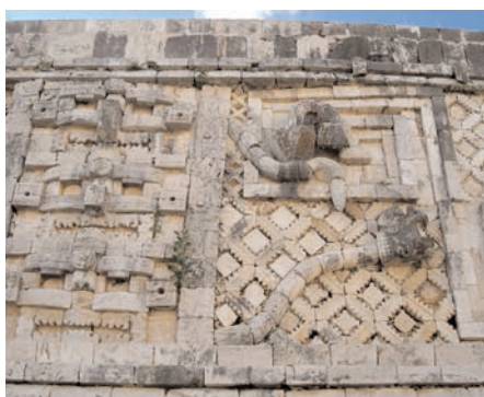
c) Degrado biologico: patine scure di natura biologica su una muratura nel sito archeologico di Uxmal (Messico). La mancanza d'inquinamento nel sito e la particolare dislocazione delle zone scure sugli elementi più esposti all'acqua meteorica, prive di segni di dilavamento, lasciano intendere la natura biologica del fenomeno.
