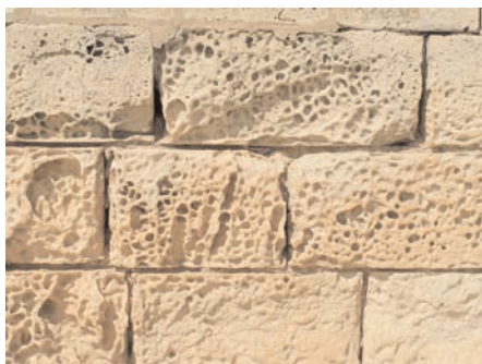
a) Degrado fisico-chimico: alveolizzazione in una muratura in arenaria a Gozo (Malta). In questo caso l'aerosol marino rappresenta una delle cause del fenomeno erosivo, dovuto a cristallizzazione salina.
