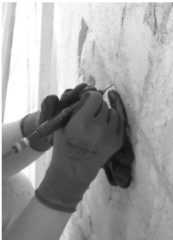
Rimozione meccanica con vibroincisore dei residui di malta debordanti sulla superficie dei conci.
