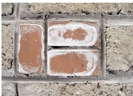
e) Efflorescenze saline su una muratura recente in tufo e laterizi (CNR, area di ricerca di Roma 1). Si nota che la cristallizzazione salina è avvenuta in particolare sui laterizi che, per le loro caratteristiche di porosità, hanno assorbito in via preferenziale i sali contenuti nella malta cementizia.
