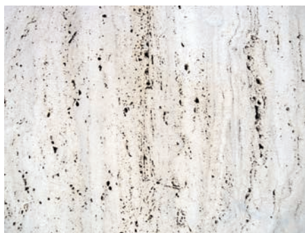
f) Travertino romano, con le caratteristiche vacuolarità e stratificazioni. La giacitura verticale delle stratificazioni evidenzia l'uso non strutturale dell'elemento lapideo (lastra di rivestimento).
