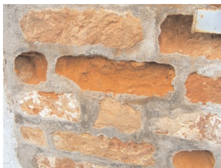
f) Disgregazione dei laterizi dovuta ad un fenomeno particolarmente accentuato di cristallizzazione salina, in una muratura storica a Venezia (foto di F. Fratini).
