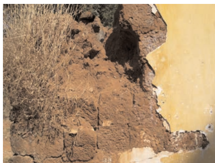
b) Degrado di una muratura in blocchi di terra a Goa (India). La caduta dell'intonaco ha favorito l'infiltrazione dell'acqua e una progressiva disgregazione della muratura, in seguito attaccata anche dalla vegetazione.
