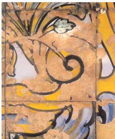
a) Degrado delle piastrelle del chiostro di S. Chiara a Napoli, dovuto ad un attacco di alghe che ha interessato solo le parti chiare della decorazione, dove poteva penetrare la luce (foto di G. Torraca).
