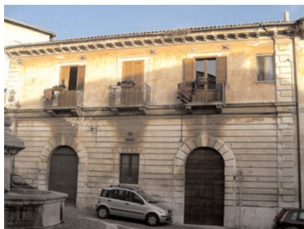
e) Tinta a calce su un edificio ottocentesco all'Aquila; questo tipo di tinta è riconoscibile per la trasparenza e la tipica modalità di alterazione per scolorimento progressivo sulle superfici esposte a dilavamento.
