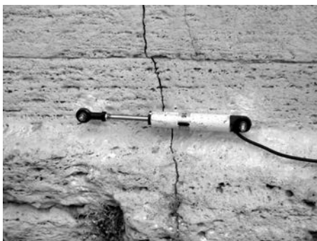
FIGURA 5.24 Roma, Colosseo. Trasduttore di spostamento posizionato a cavallo di una lesione
