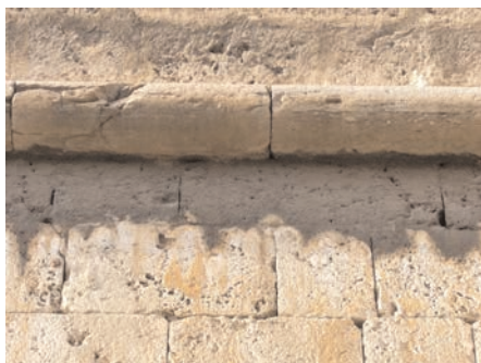
a) Degrado chimico: probabile formazione di croste nere sulla torre campanaria di S. Maria di Paganica all'Aquila. Il deposito di polveri è evidente sulla parte sottostante la cornice, al riparo dell'azione dilavante delle acque meteoriche.
