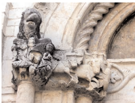
c) Degrado chimico: erosione degli elementi scultorei più esposti all'azione meteorica sul portale della chiesa di S. Marciano all'Aquila. Si notano zone scure (probabili croste nere) e parti più sbiancate, dovute a dilavamento.
