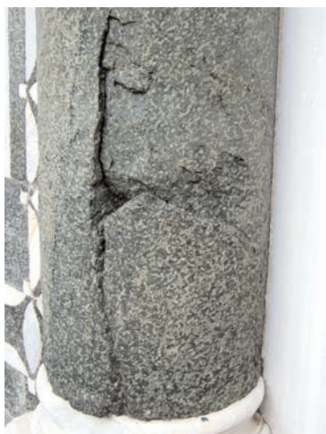
c) Degrado fisico-meccanico: fenomeno del "termoclastismo". La colonna in serpentinite, nella facciata della Badia Fiesolana (Firenze), è fratturata a causa delle dilatazioni termiche. In particolare, il colore scuro fa sì che il materiale assorba molto calore per irraggiamento ma la bassa conducibilità termica ostacola la trasmissione del calore all'interno; si creano quindi delle tensioni per dilatazione differenziale (foto di F. Fratini).
