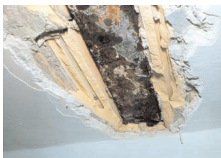
f) Degrado di un profilato metallico nella casa D'Annunzio a Pescara, dovuto all'accostamento con materiali non compatibili (malte di gesso). Il gesso ha determinato la corrosione di tutti gli elementi metallici del solaio, con evidenti segni di disgregazione.
