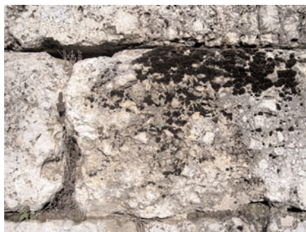
d) Degrado biologico: presenza di muschio su un calcare vacuolare, in cui le cavità hanno favorito la vegetazione.
