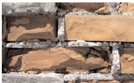
d) Degrado fisico: laterizi con fratture e scagliature dovute a fenomeni di gelività.
