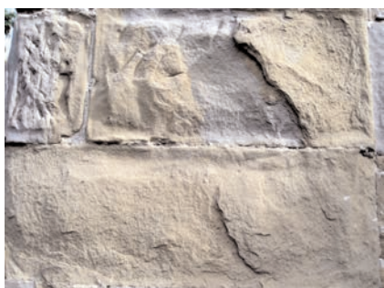
c) Muratura in arenaria nella chiesa dei SS. Pietro e Paolo a Cesacastina (Teramo). Si nota la struttura granulare dell'arenaria, particolarmente vulnerabile ai fenomeni erosivi, tanto da facilitare la formazione di vistose esfoliazioni.
