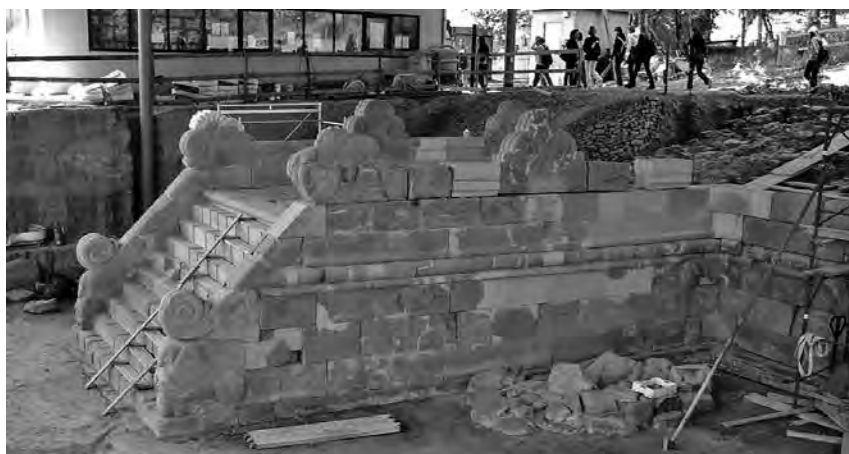
Fig. 15 - Rampa ricostruita nel tumulo del Secondo Melone del Sodo a Cortona (foto A. Naso).
