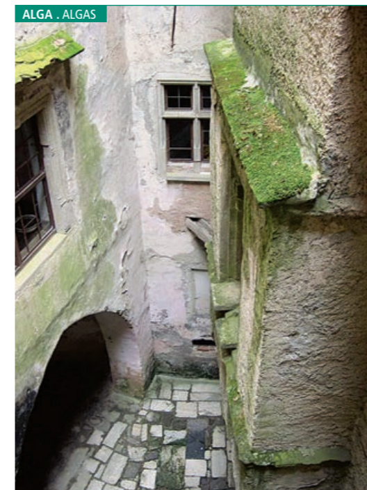
Green algae developing on a lime render on stone masonry. Algas verdes desarrollándose en un revestimiento de cal sobre mampostería de piedra.
