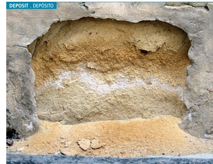
The material detached from the sandstone block forms a deposit . El material desprendido del bloque de arenisca constituye un depósito .
