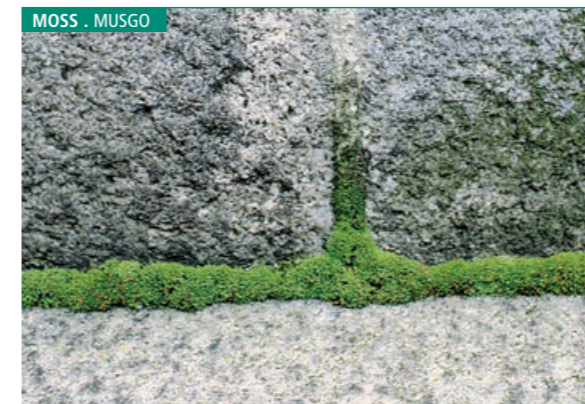
Moss on the joints of a granite ashlar. Musgo en las juntas de una sillaría en granito.
