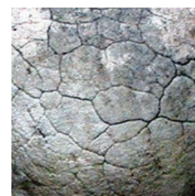
CRACK & DEFORMATION GRIETA Y DEFORMACIÓN
