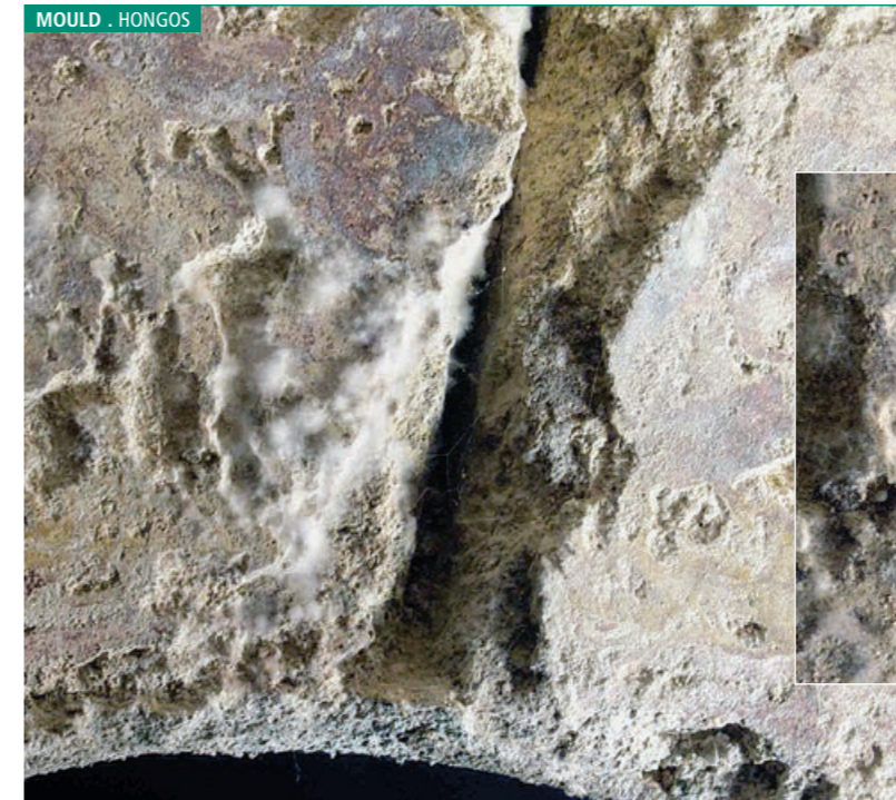
Down-like white mould on a limestone block. Colonia de hongos de color blanco sobre un bloque de arenisca.
