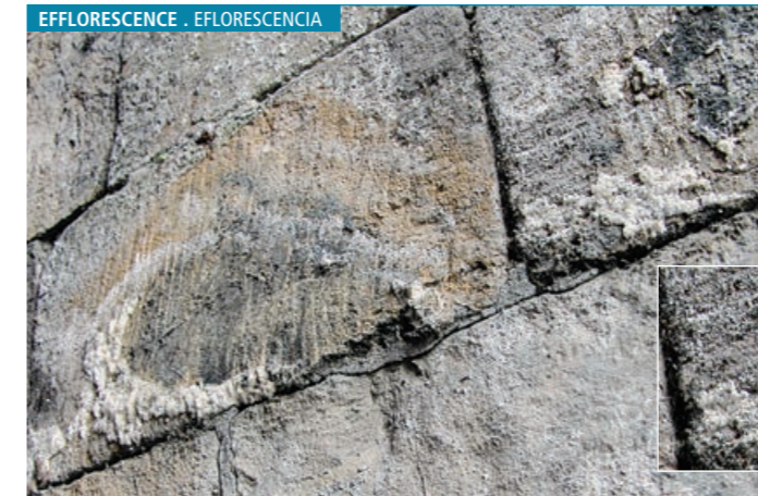
Efflorescence on dolomitic limestone related to historic air pollution. Eflorescencia en caliza dolomítica relacionada con contaminación atmosférica histórica.
