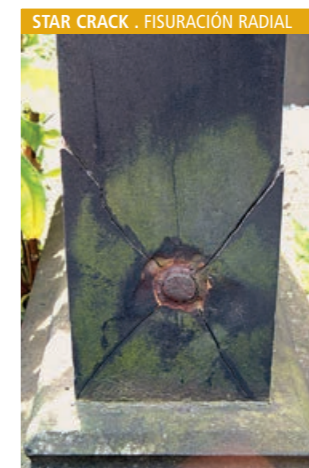
STAR CRACK . FISURACIÓN RADIAL
