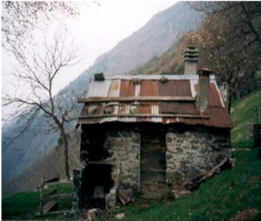
Fig. 1.4 - Corrosione generalizzata di lamiere zincate sul tetto di una baita a Nestrelli (Valtellina)
